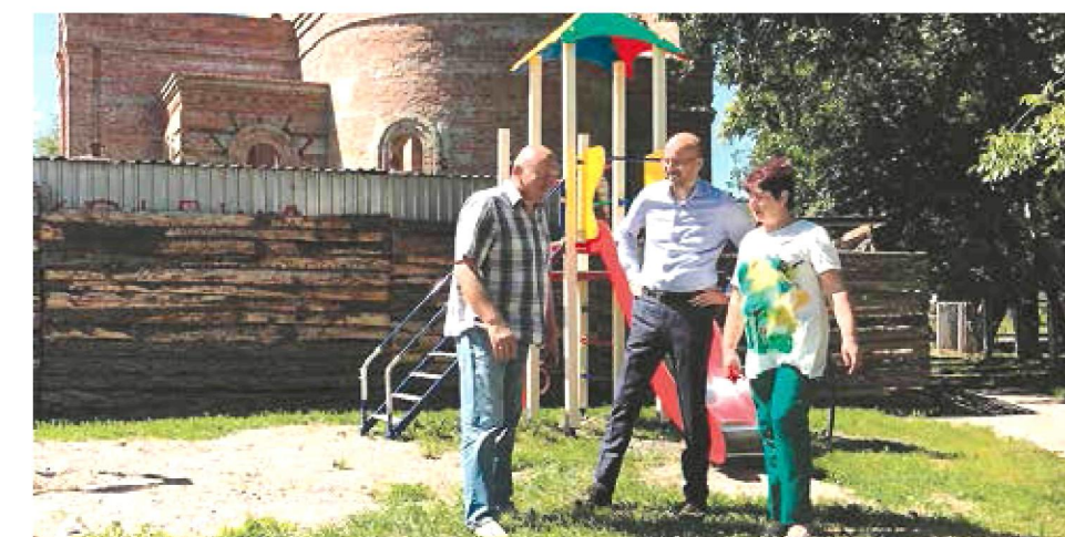
12 серпня. Сміла. Разом із моїми помічниками Олегом Черненко та Лідією Зайвою інспектуємо хід будівництва спортивного майданчика по вул. Ротондівській
